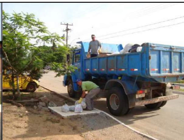
FOTO 04 – Resíduos da Construção Civil
