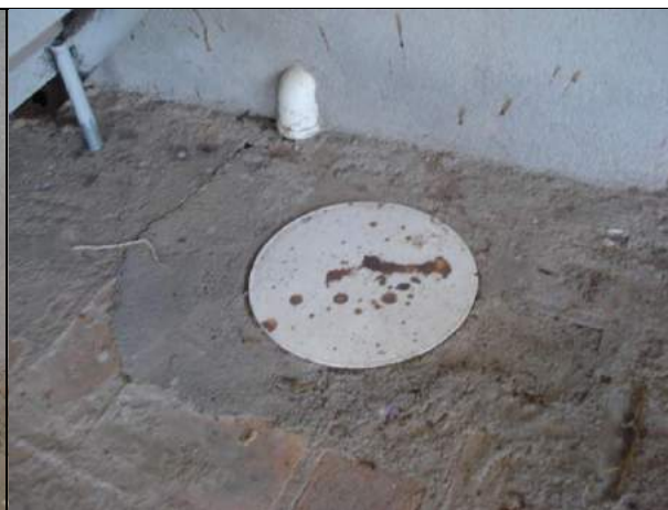
FOTO 02 – Caixa de Gordura
