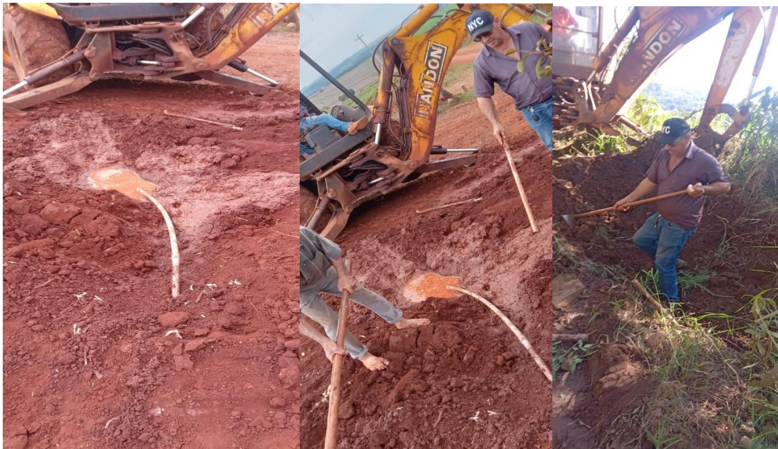
Foto 14,15 e 16 Conserto da rede de água linha Sitio Langner e Linha São José
